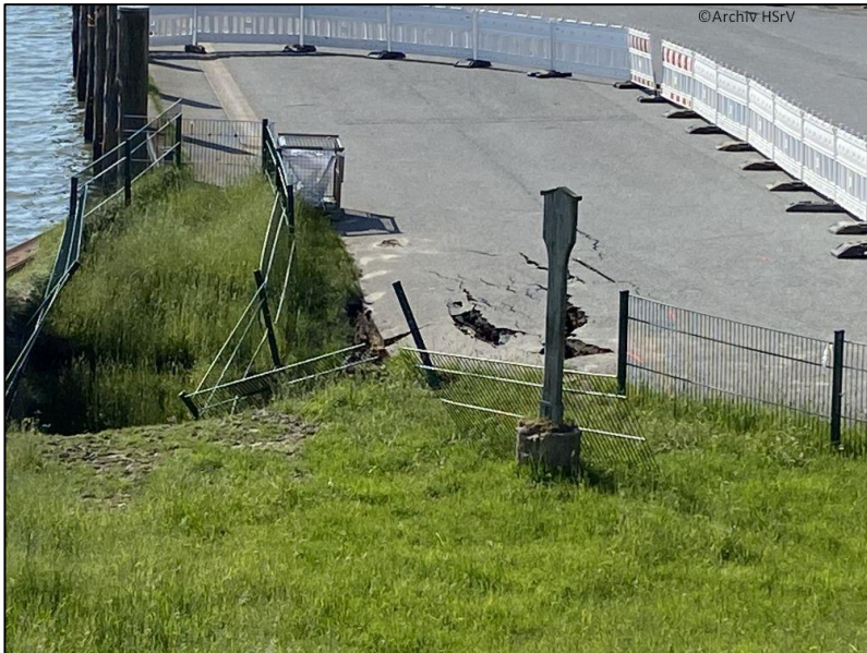
Sackung durch Auskolkung am Pellworm-Anleger (Foto: Christian Melzer)
